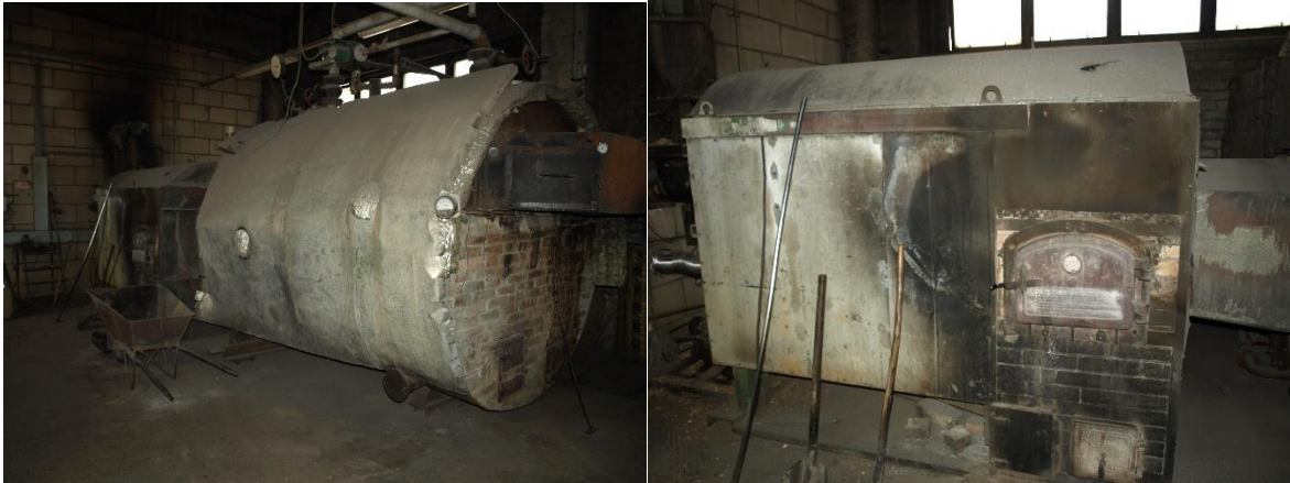
Joonis 3. Vaade katlale
